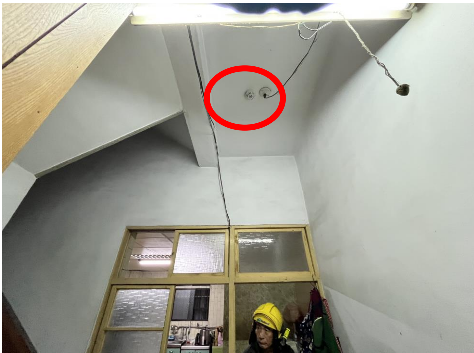
圖二：住警器安裝於一樓樓梯間
