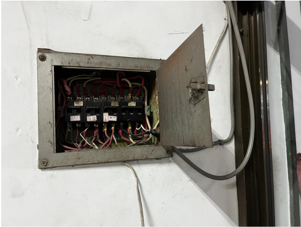
圖一、未能發現火點(現場檢視電線尚無異常，只是較為老舊)
