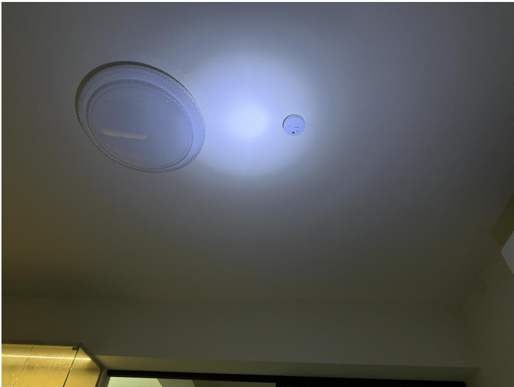
圖二：住警器安裝於一樓客廳
