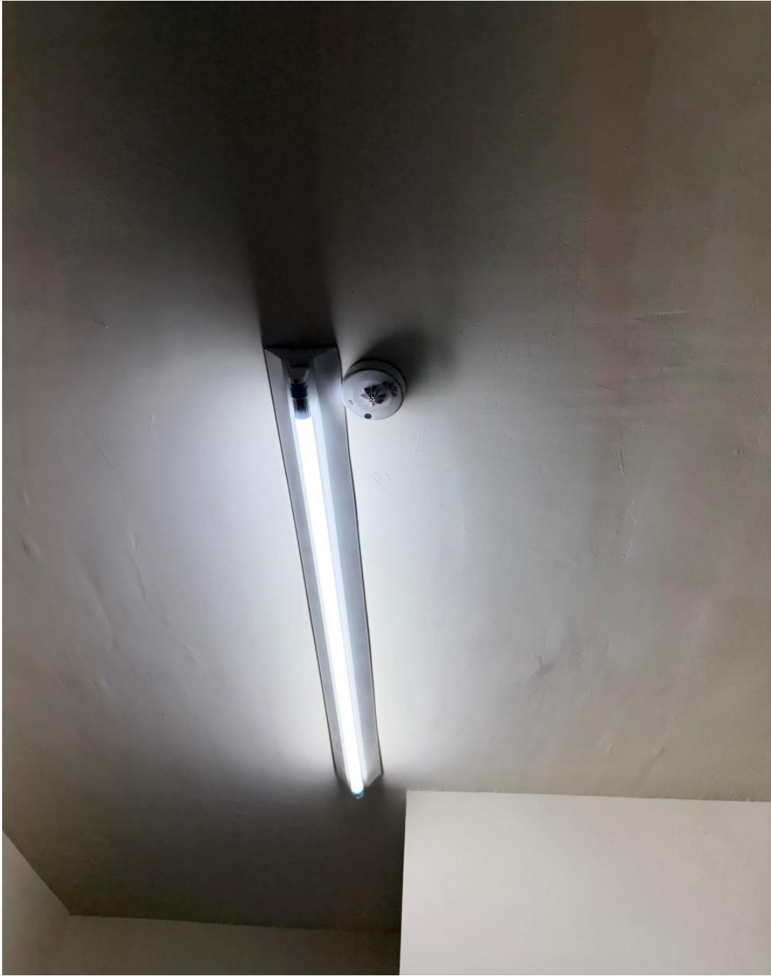
圖三、住警器裝設位置
